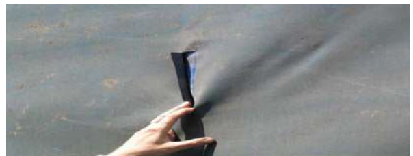
Рисунок 6.3 (б) – Розрізаний під час перевезення брезент. Такий причіп не варто допускати до продовження перевезення МДП без ремонту
